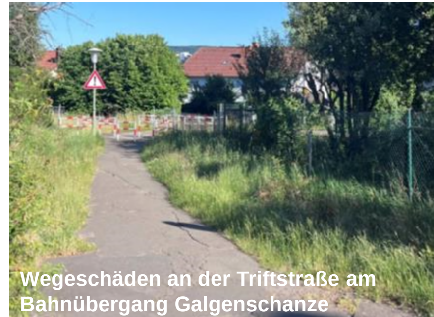
Unebenes Pflaster an der Triftstraße
