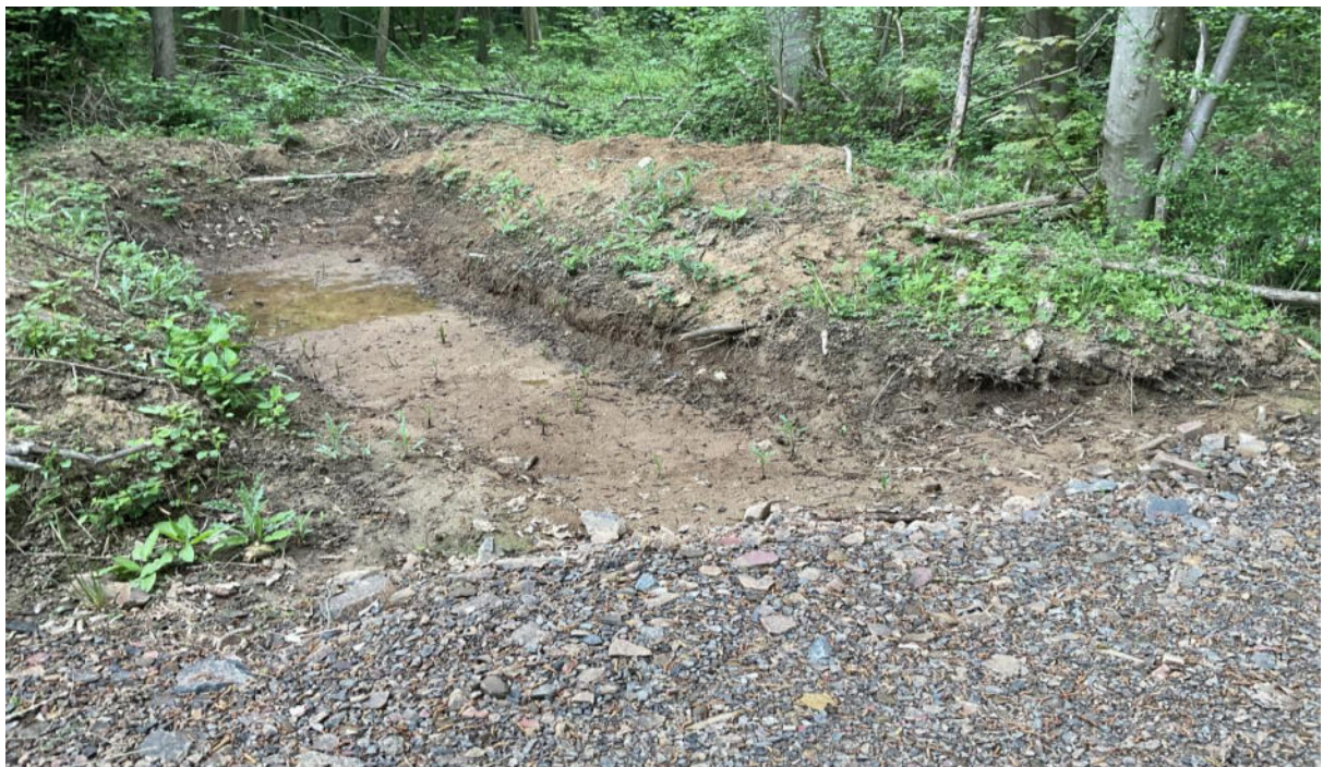
Beispiel Maßnahmenvorschlag (RF)
