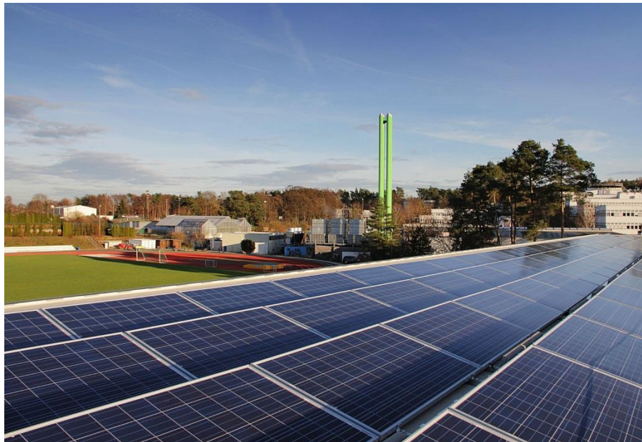
Abbildung 1 Die Photovoltaikanlage des Sportbundes Pfalz e.V.
