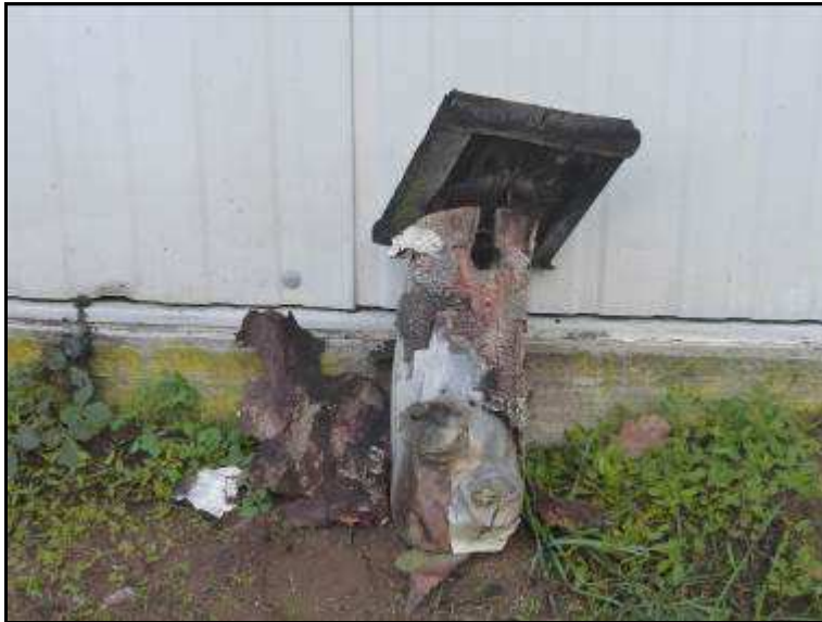
Abb. 12: ramponierter Vogelkasten mit einem Nest im Süden der Werkhalle
