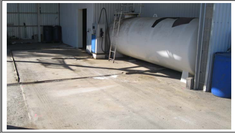
Foto 3: Untersuchungsfläche Tankstellenbereich, Zapfsäule und oberirdischer Dieseltank
