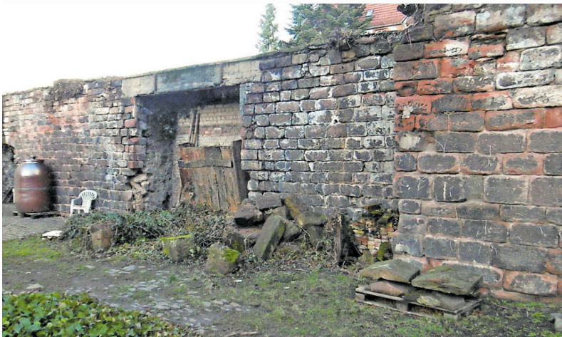
Vor der Sanierung war die historische Stadtmauer am Wadgasserhof stark einsturzgefährdet
