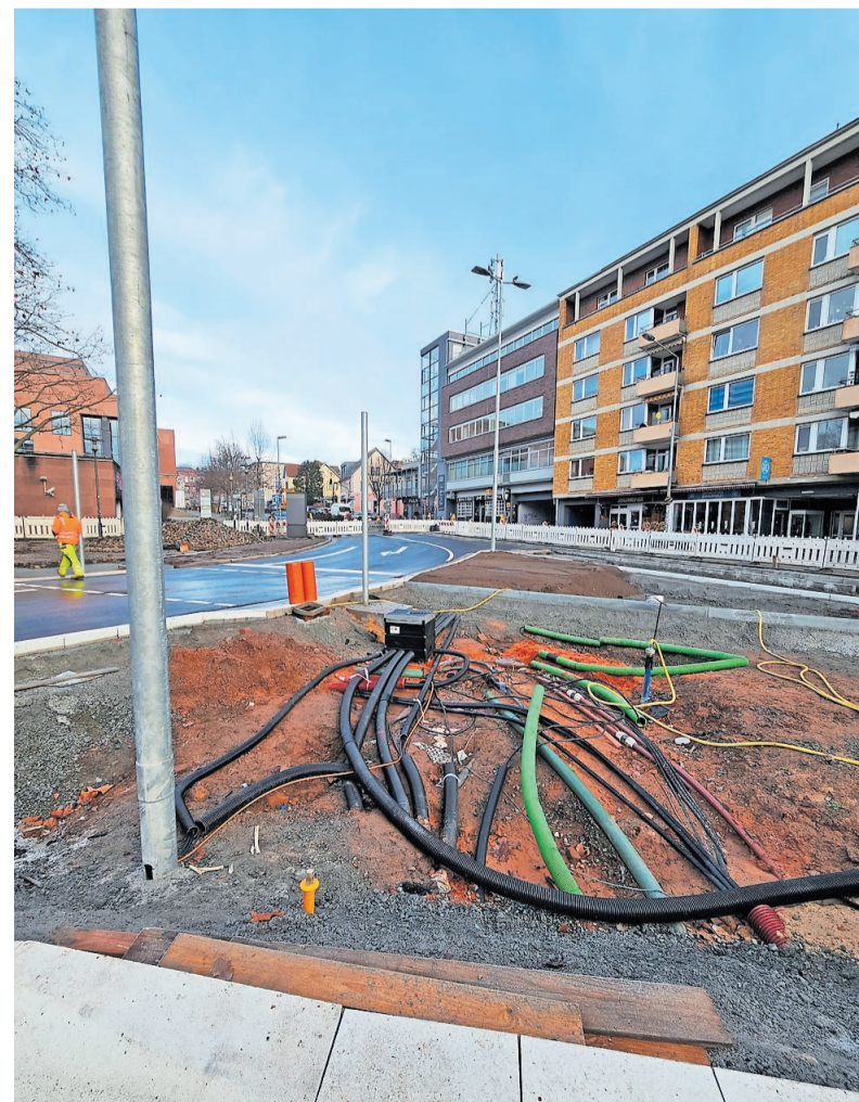
Das Foto zeigt gut, welche Herausforderungen eine Großbaustelle wie die in der Stadtmitte mit sich bringt. Zusätzlich zu bereits vorhandenen Leitungen müssen auch noch neue gelegt werden. Gerade in der Stadtmitte, wo vieles zusammenläuft, wird es da oft eng. Baumpflanzungen sind von daher nicht ohne Weiteres überall möglich. Trotzdem wird es am Ende gelungen sein, im Baufeld mehr als 20 Bäume neu zu pflanzen.
