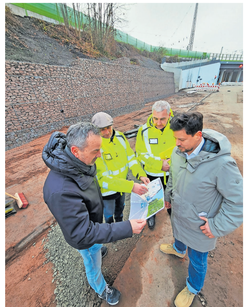
Beim Ortstermin vor der frisch fertiggestellten Gabionenwand: Baudezernent Manuel Steinbrenner (rechts) beratschlagt mit Alexander Mock, Christoph Schenk und Referatsleiter Sebastian Staab vom Tiefbaureferat
