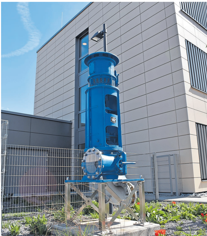
Echter Blickfang: Die alte Regenwasserpumpe der Firma KSB
