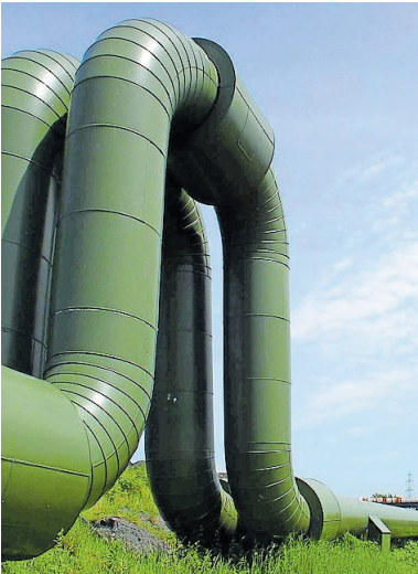
Ein Anschluss an das Fernwärmenetz der SWK wäre ein sinnvoller und wichtiger Schritt
