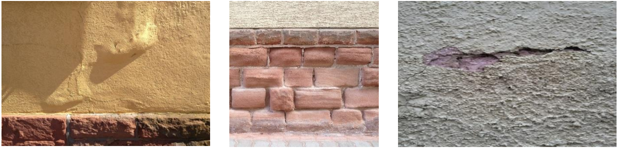
Abbildung 1: Bauschäden Bahnheim (eigene Darstellung)
