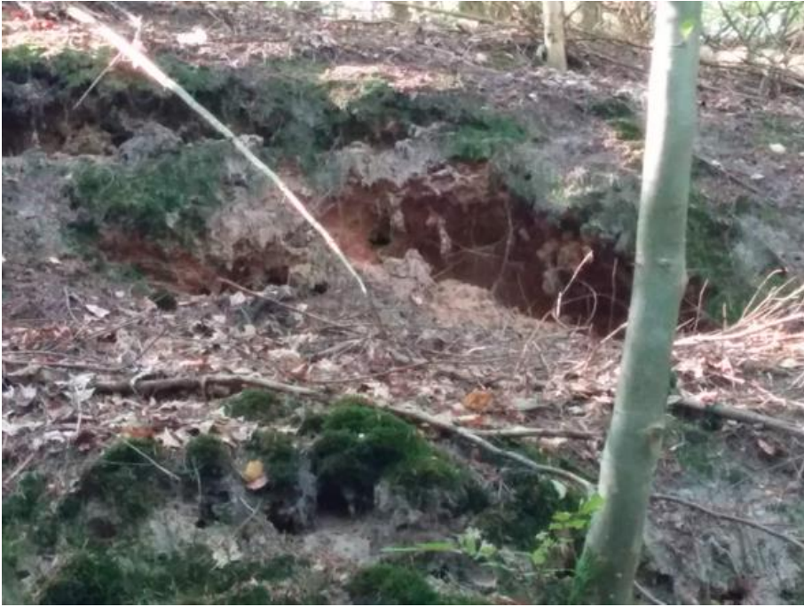
Ausgehöhlter Bereich an der südlichen Hangseite
