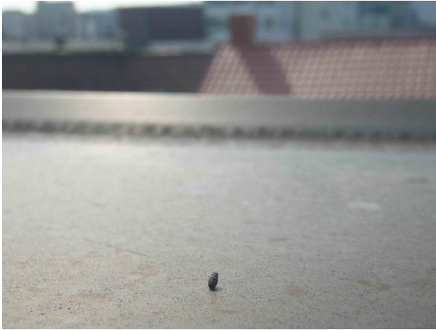
Abbildung 8: Einzelnes Kotpellet auf einem Mauerabschlussblech am südlichen Rand des unteren Parkdecks
