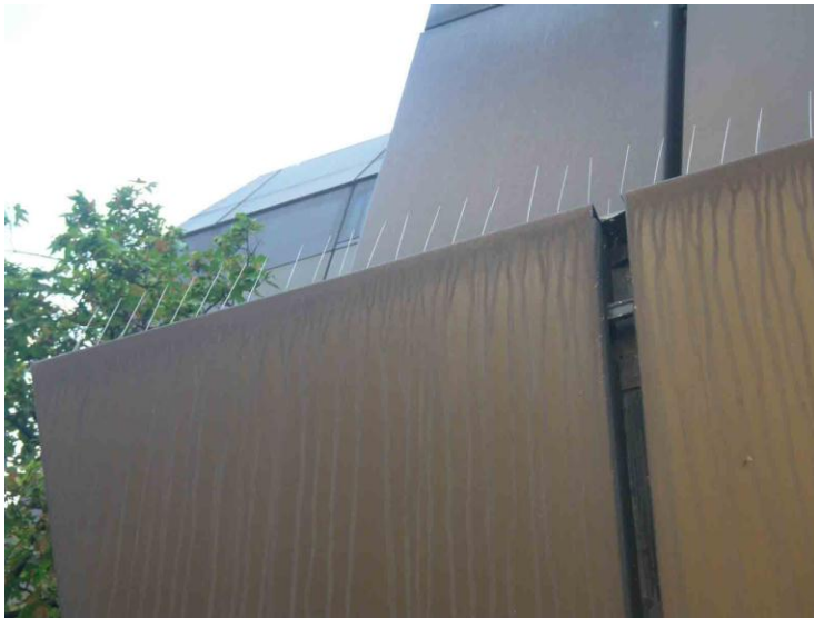
Abbildung 4 Blick auf die glattwandige Blechverkleidung der Außenfassade des ehem. Karstadt-Gebäudes mit Schutzvorrichtung gegen Straßentauben
