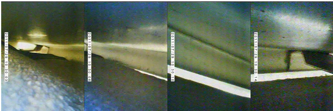
Abbildung 13: Blick unter das Mauerabschlussblech aus Abb.11 (Kameraschwenk von links nach rechts). Der großvolumige Hohlraum ist nach mehreren Seiten offen und damit für zugluftempfindliche Fledermäuse ungeeignet.
