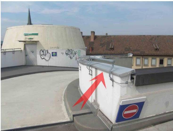
Abbildung 11: Endoskopisch untersuchtes Mauerabschlussblech an der südwestlichen Auffahrt zum oberen Parkdeck (s. auch Fotosequenz in Abb. 13 und Filmsequenz im Anhang).
